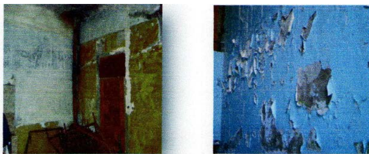
Figure: 13 & 14 : Décollement des enduits et dégradation de la peinture : Blocs réfectoire et administration.
